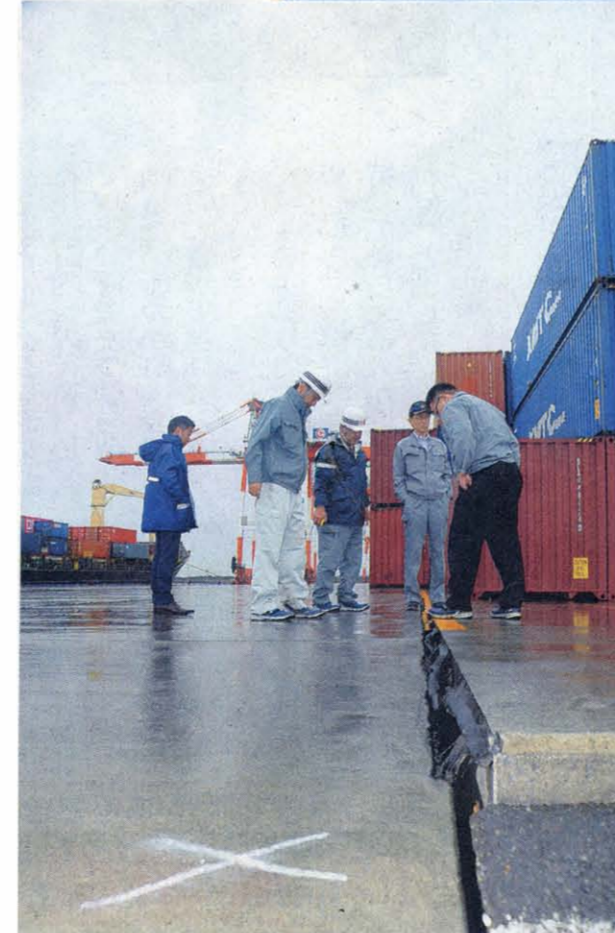
地盤の液状化や路面の陥没などの被害が出た苫小牧東港国際コンテナターミナル
